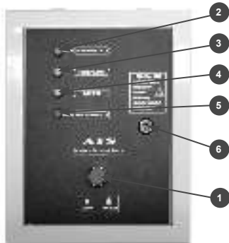
Рис. 13 Контрольная панель блока ATS
